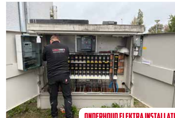
ONDERHOUD ELEKTRA INSTALLATIE
